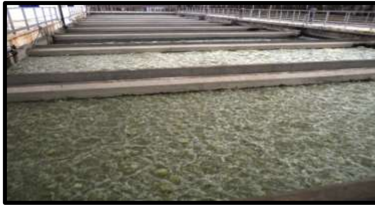
Figure 10: Lavage du filtre à sable avec l'eau et l'air (Station de Traitement des eaux-Koudiet Lamdaouar, Timgad -Algérie)
