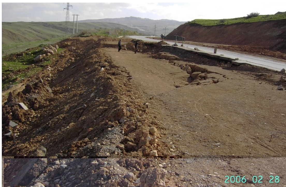
Photo 4: Glissement au PK 3+800 de la RN 79A survenu en 2006
