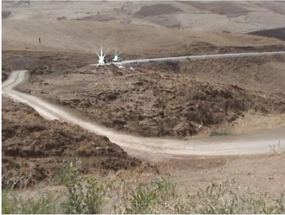
Photo 5: Coulée argileuse survenue en 2005 sur la RN 52 de la wilaya de Mila
