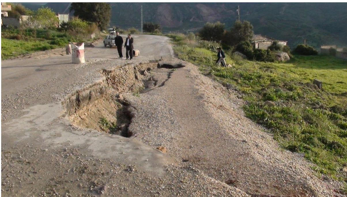
Photo 3: Glissement au PK 68+800 de la RN 29 survenu en 2009
