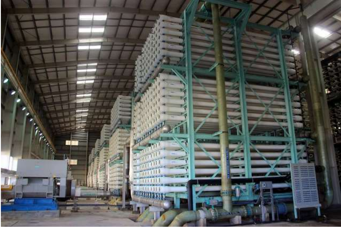
La plus grande station au monde de dessalement d'eau de mer par osmose inverse d'El Mactâa (Oran) inaugurée en Algérie (2014)
