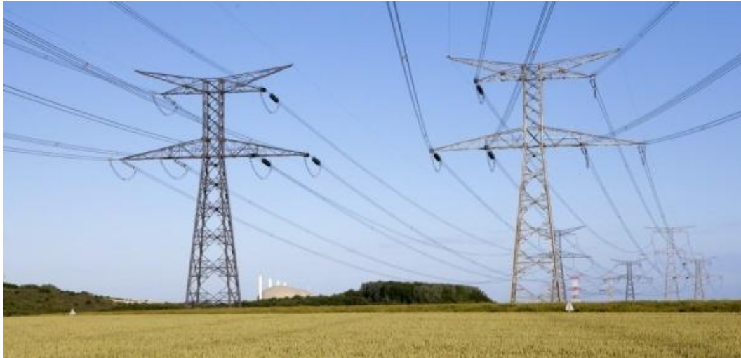
Figure (8): Pylônes composés d'un treillis en acier pour les lignes à très haute tension
