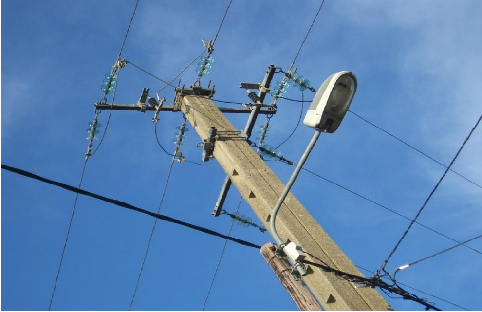
Figure (6): Poteau en bois ou mât en béton pour les lignes à moyenne tension
