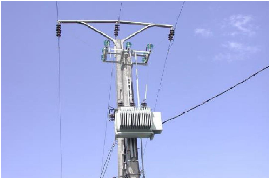
Figure (10):transformateur sur poteau
