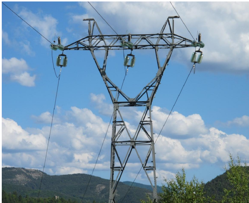
Figure (7) : Pylônes pour les lignes à haute tension
